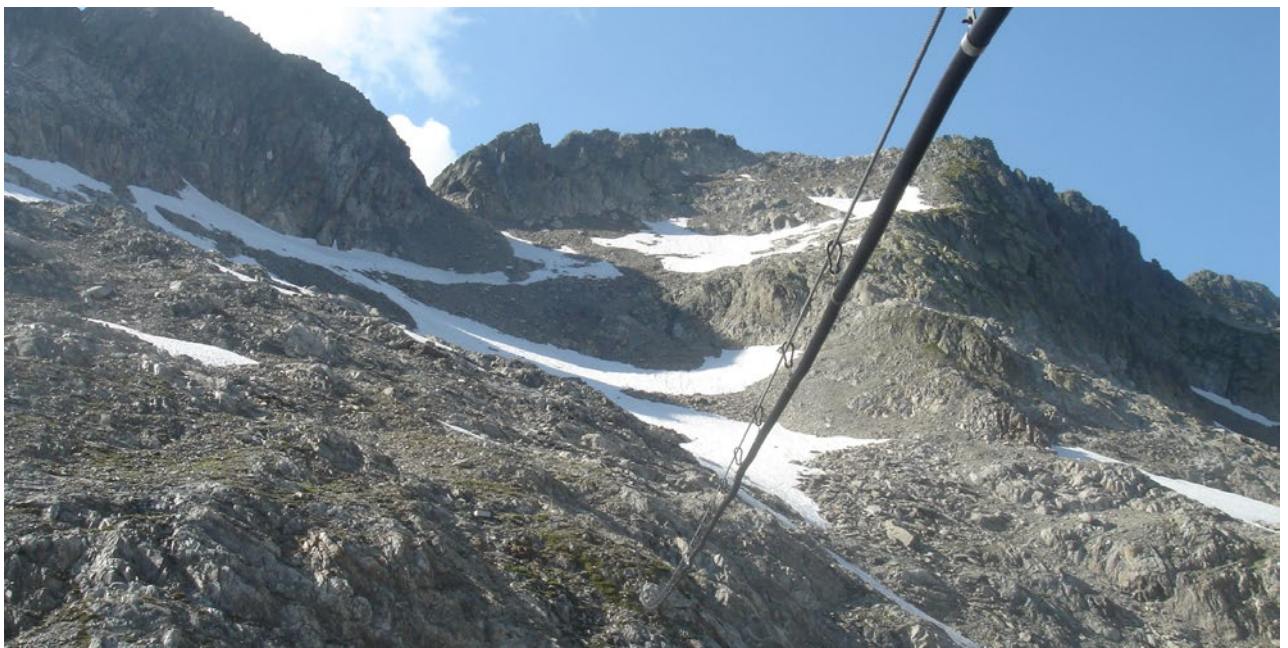
Eine Freiluft-Wasserleitung versorgt die Camona da Cavardiras CAS mit Wasser von einem Schneefeld.
